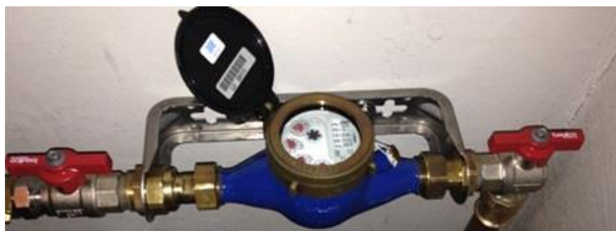
Vattenmätare monterad i konsol.
